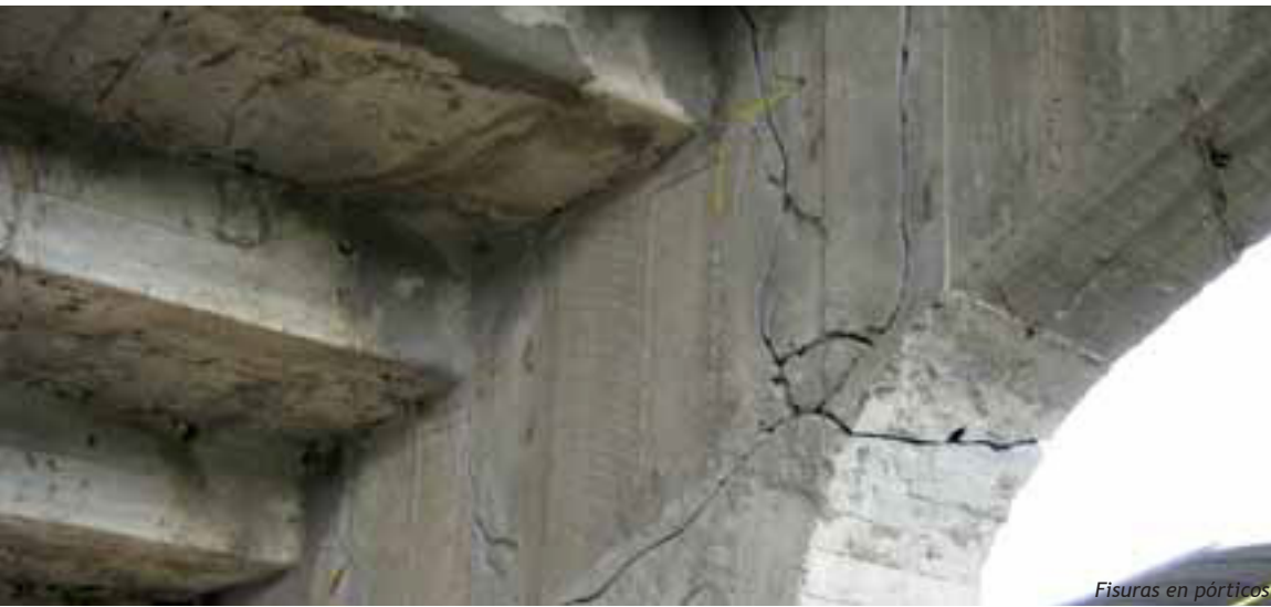
Fisuras en pórticos
